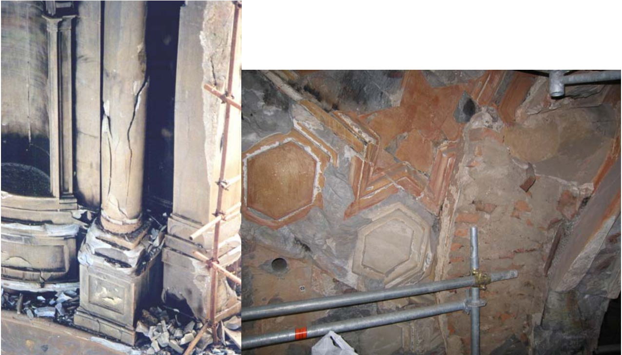
Situazione di grave degrado del paramento lapideo interno con fessurazioni, rigonfiamenti, distacchi, alterazioni cromatiche e parziale messa in luce delle strutture murarie retrostanti
