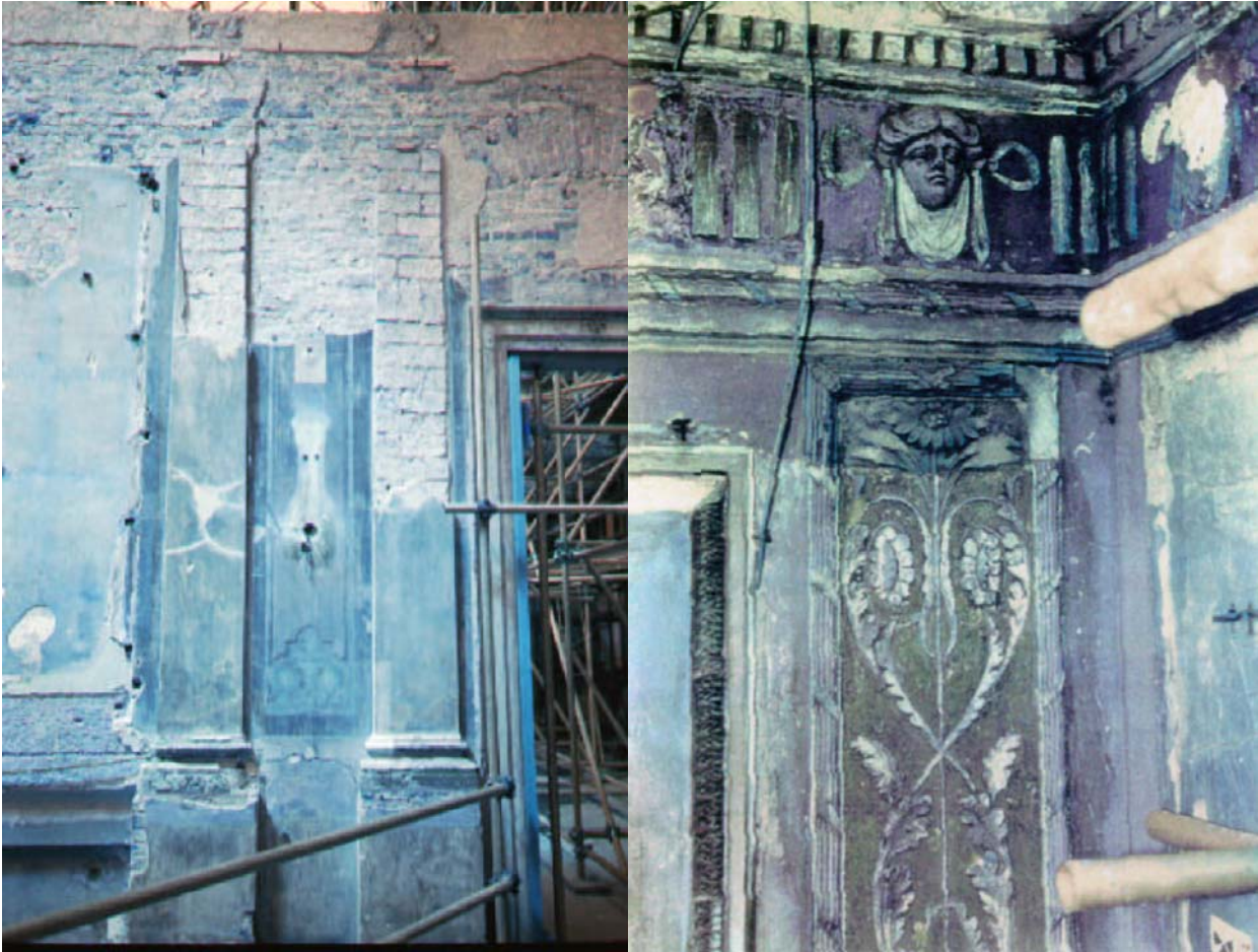
Lacerti di intonaco a marmorino e di stucchi forti presenti al piano delle Sale Apollinee e sopravvissuti all'incendio
