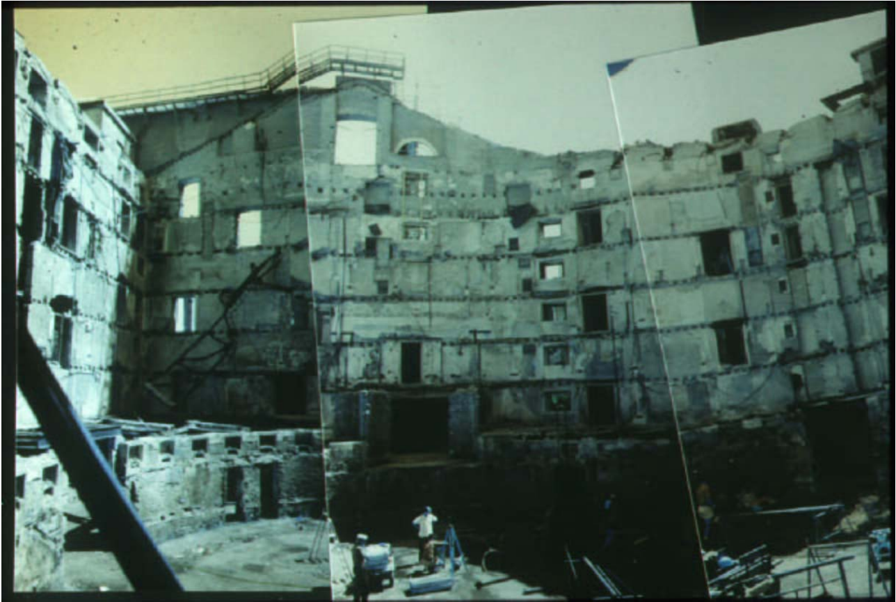
Il castello dei palchi completamente bruciato; restano le pareti perimetrali un tempo esterne ai corridoi
