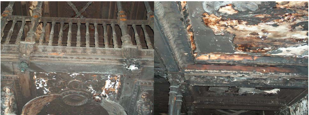
Parziale carbonizzazione superficiale delle decorazioni del Foyer
